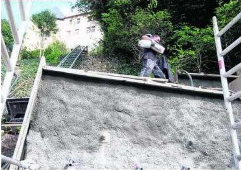
Hier am Hang kam einiges ins Rutschen: Kurzfristig mussten 550000 Euro freigegeben werden, um hier Hangsicherungsmaßnahmen zu veranlassen. Die laufende Bewirtschaftung der Burg Mildenstein kostet jährlich etwa 150000 Euro. Foto: Wolfgang Sens
